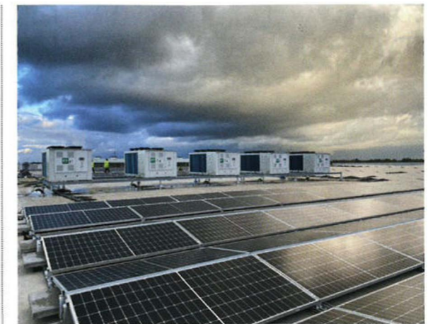
Zonnepanelen op het dak van het DC in Weert.
