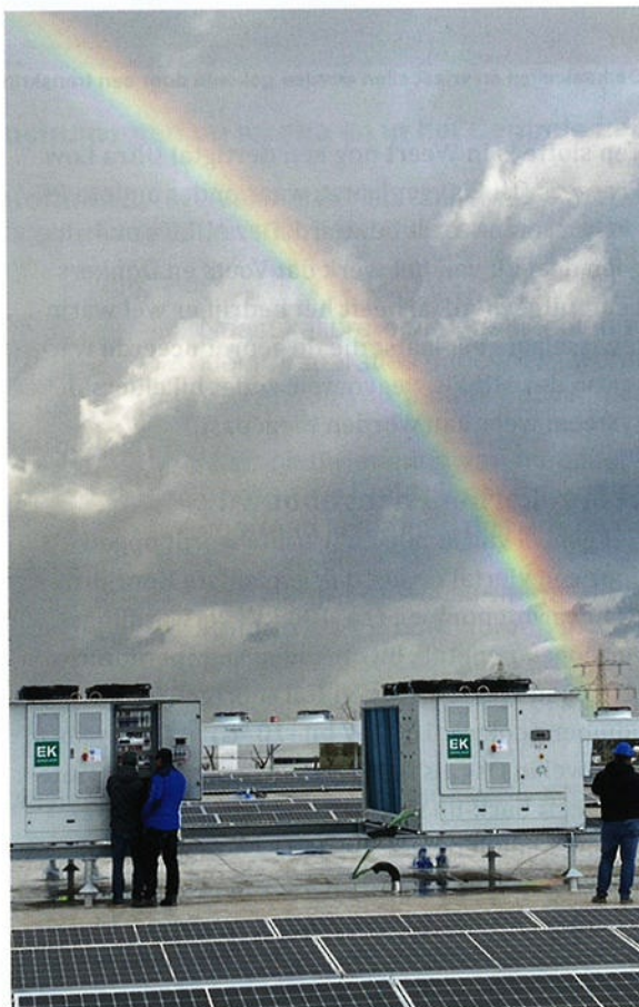
Twee van de Hera-propaanwarmtepompen.
